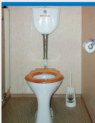
Alte Stand WC Anlage
