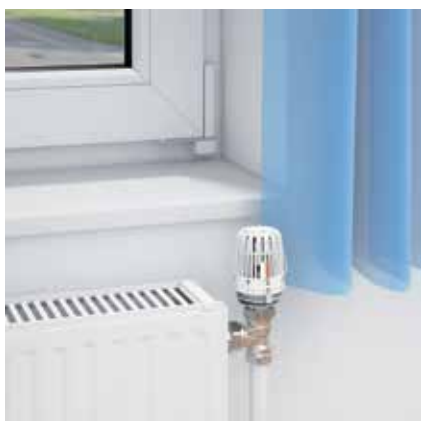
falsch Der Thermostat-Kopf mit eingebautem Fühler darf nicht senkrecht montiert werden.
