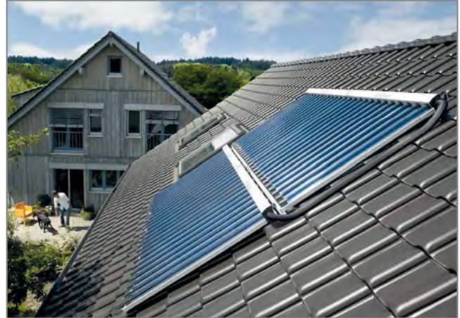
Abb 21: Nutzung von Solarenergie durch Röhrenkollektoren
