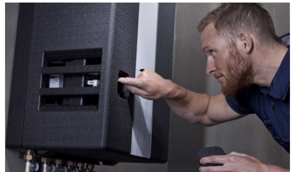
Durch den Ausschnitt in der Frontabdeckung gibt es freien Zugang zu der Pumpe.
